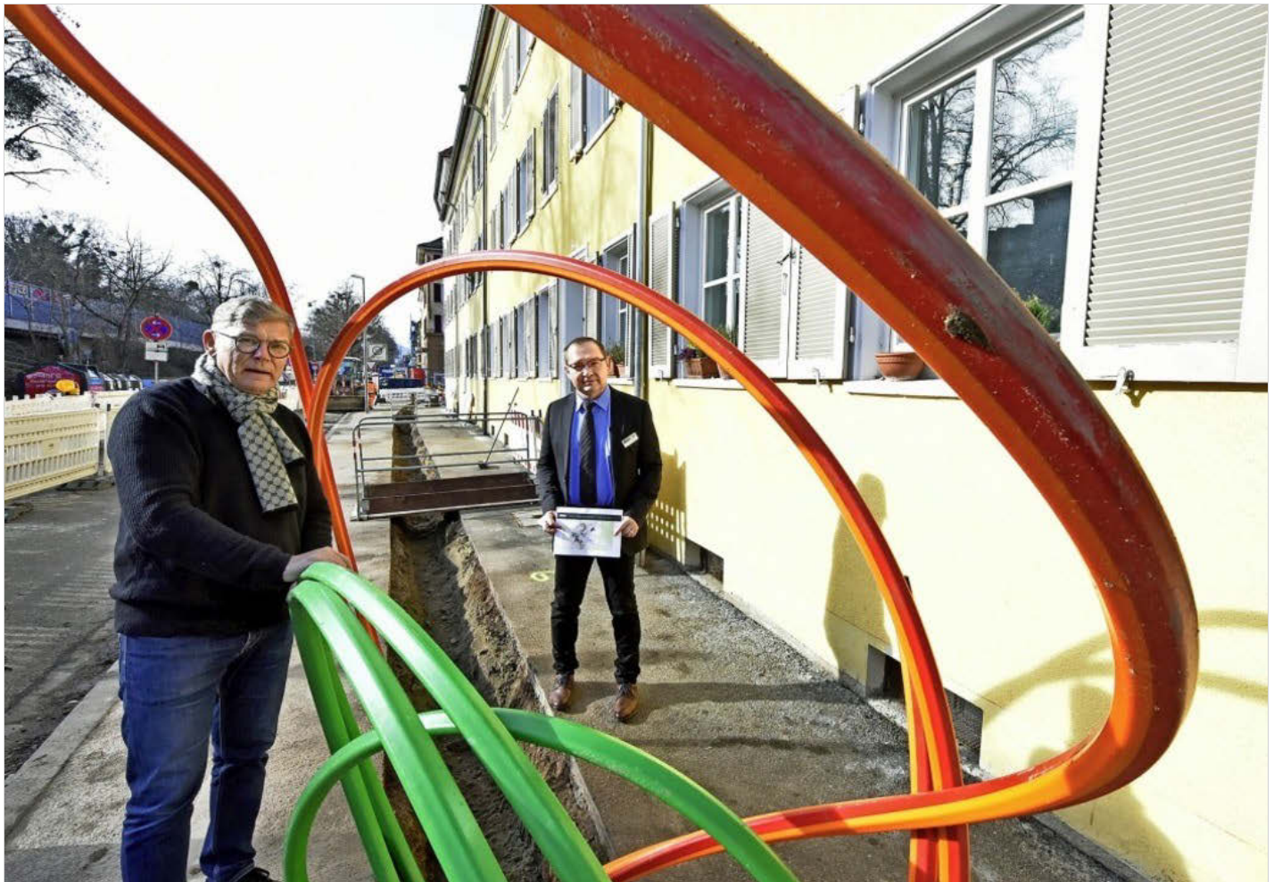
Bernhard Ginter und Saša Vujinovic (von links) mit Leerrohren für Glasfaser in der Kandelstraße Foto: Michael Bamberger
